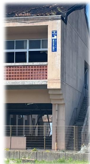
2階まで水没した小学校。 屋上に避難し難を逃れる。
