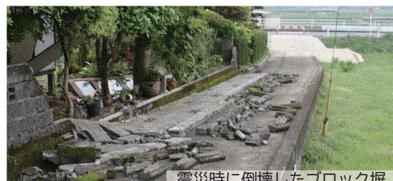
震災時に倒壊したブロック塀
