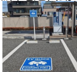
急速充電器(市役所)
