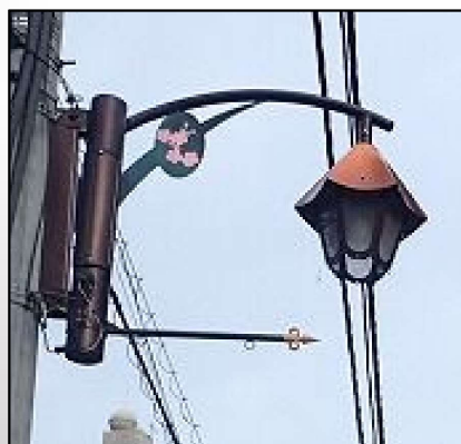
現況照明灯（電柱共架）
